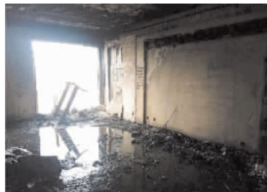
居民家失火后一片狼藉。
