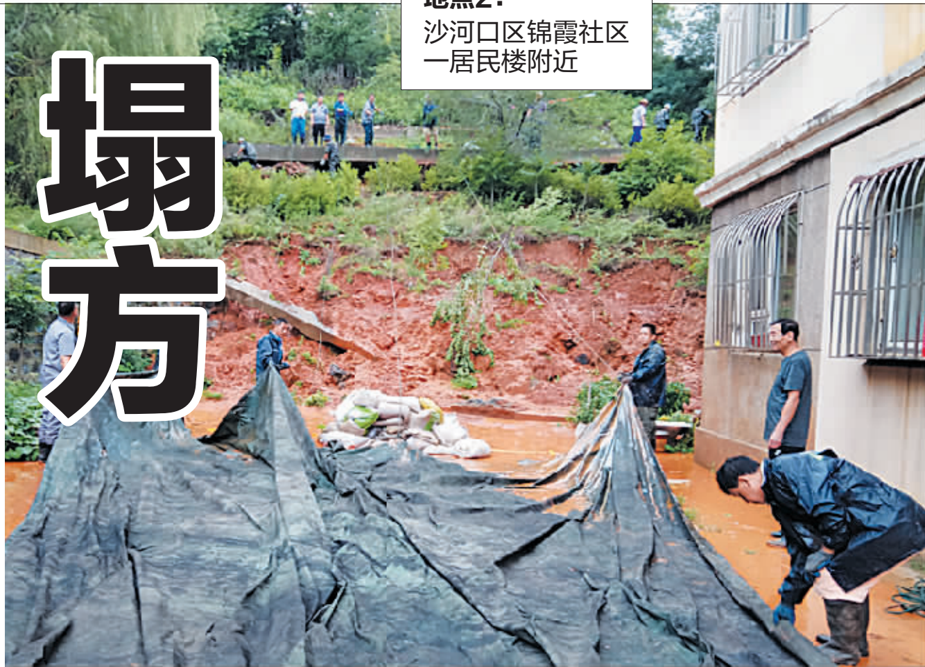
挡土墙塌方各方紧急处理。
