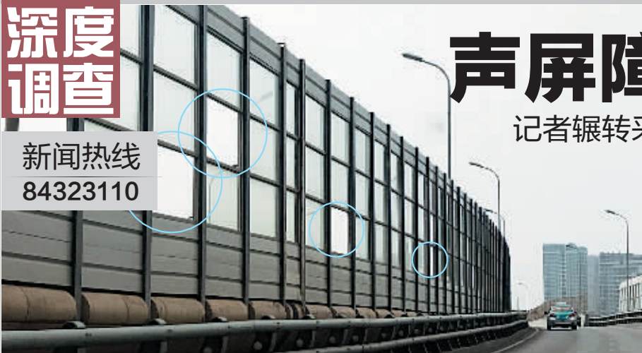
多块声屏障玻璃碎裂(画圈处)。
